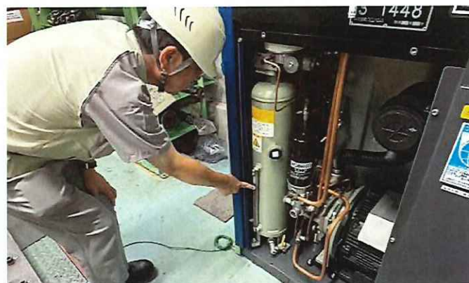
▲ 設備の保全・点検、工具・測定器の管理
