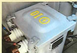
■ 変圧器(トランス)
