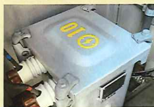
■ 変圧器(トランス)
