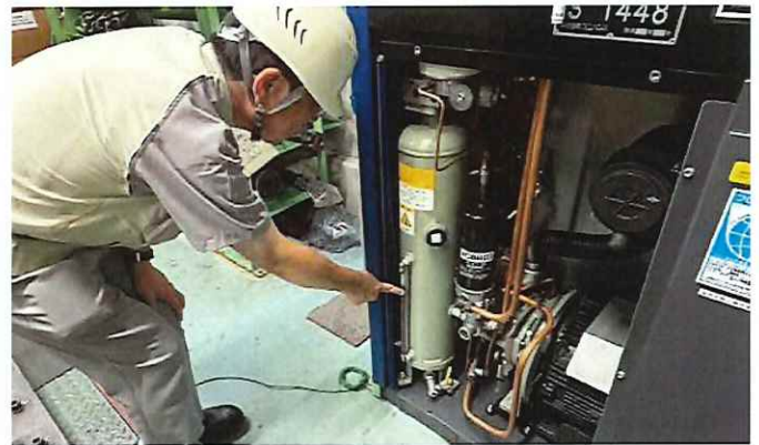
▲ 設備の保全・点検、工具・測定器の管理
