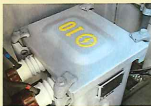
■ 変圧器(トランス)
