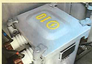
■ 変圧器(トランス)
