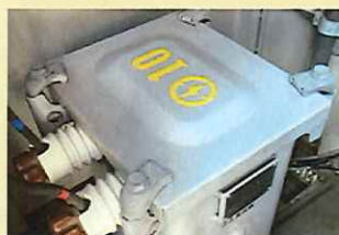
■ 変圧器(トランス)
