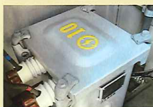
■ 変圧器(トランス)
